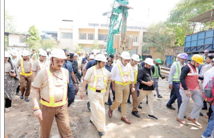
मुख्यमंत्री रेखा गुप्ता आर. के. आश्रम मार्ग मेट्रो स्टेशन पर चल रहे निर्माण कार्यों का निरीक्षण करते हुए।
