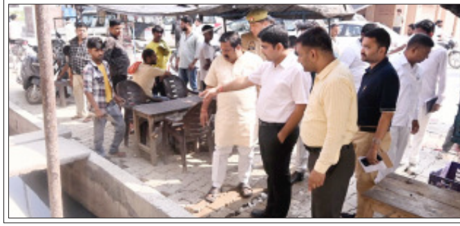
सम्भल नगर पंचायत बबराला द्वारा निर्मित नाले का निरीक्षण करके जिलाधिकारी अंकित खंडेलवाल।
