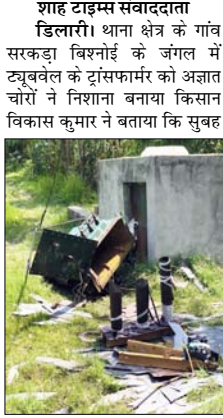
6:00 बजे खेत पर पानी देने के लिए सुबह पर पहुंचा तो देखा कि ट्रांसफार्मर खम्बों से नीचे गिर पड़ा है और उसके अंदर का पीतल कॉपर एवं अन्य कीमती सामान नहीं है अज्ञात चोरों द्वारा ट्रांसफार्मर का सभी कीमती सामान चुरा ले गए और खाली खोखा वही छोड़कर
